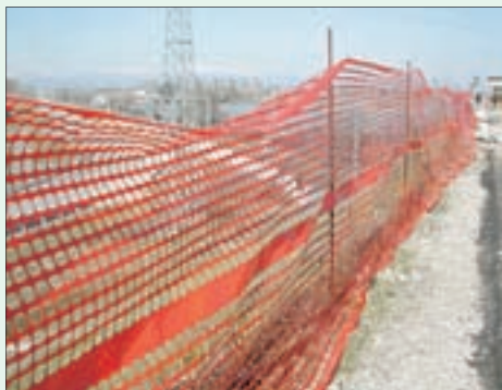
Situazione non regolare, la rete non è sufficiente per proteggere dalla caduta dal ciglio dello scavo
