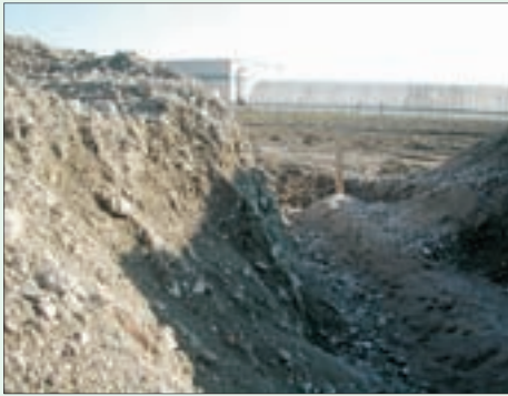
Situazione non regolare, dal fronte dello scavo possono cadere dei sassi
